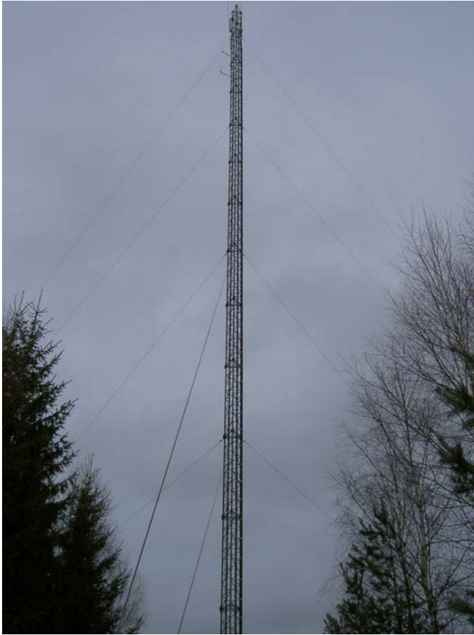
Abbildung 10: Antennentragmastanlage in Südschweden, Dezember 2007, Masthöhe ca. 50 m bestückt mit GSM 900 (Sektorantennen) und NMT 450 Rundstrahlantennen, Quelle: G. Oberfeld
